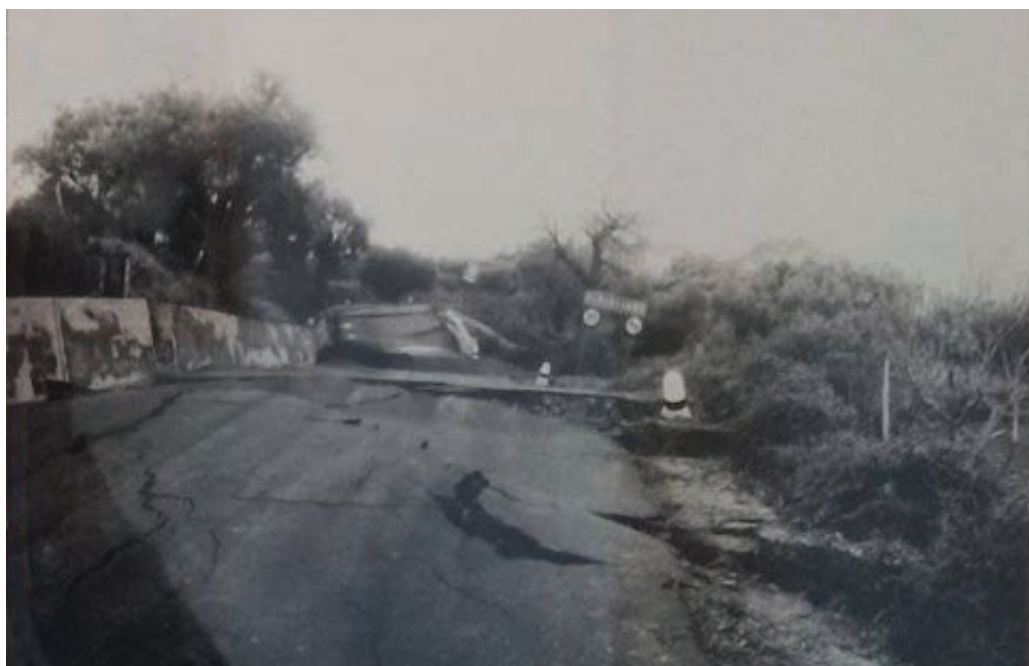
Fig. 10: Danni causati dalla frana sulla SS103 in prossimità dell'accesso al paese di Cirigliano da nord.
